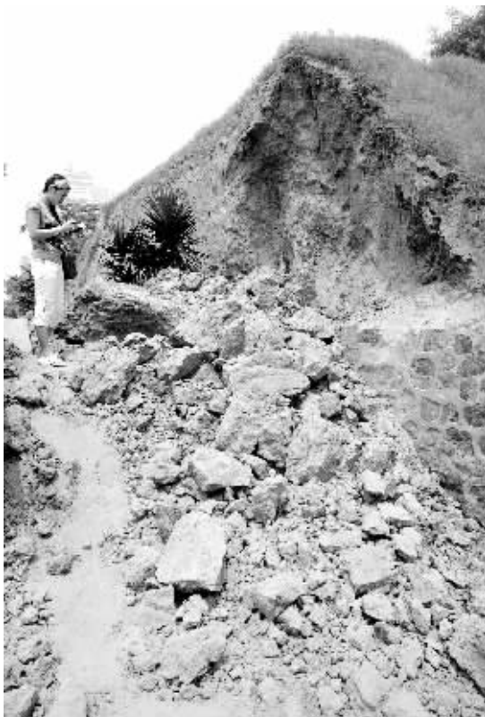
紫荆山路与城南路口附近,紧挨着路边的商城古城墙出现塌方,部分土块已飞到行车道上。 晚报记者 赵克 图
