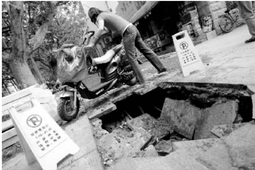
从学校门前经过的人小心翼翼地绕过大坑。 晚报记者 赵克图
