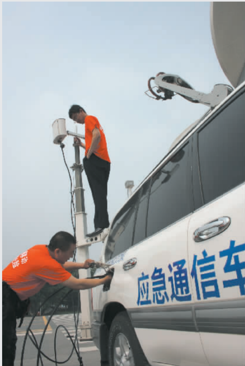
▲郑州移动抢险队的队员正在调试卫星通讯车
