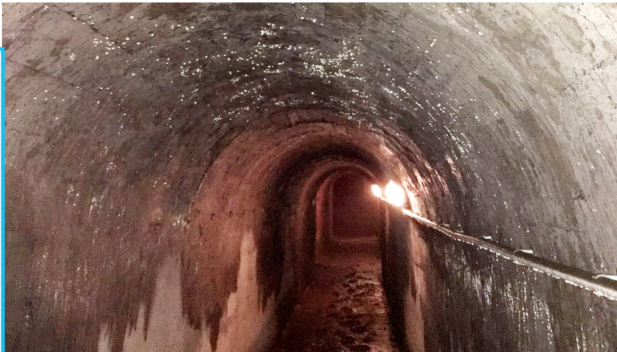
友爱路55号院内防空洞有一处漏水,已及时处理
