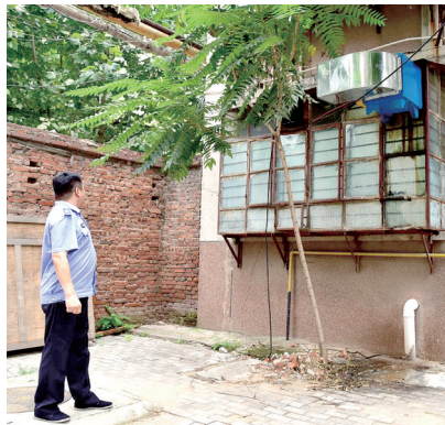
饭店烟道安装有油烟净化器
