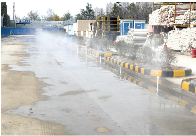
万科荣成·兰园工地场区硬化道路两侧,施工方装了雾喷装置。
