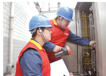
对供电设备开展特巡
