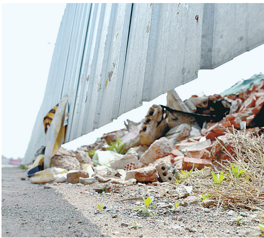
工地围挡下面空了一截,成了“九分裤”
