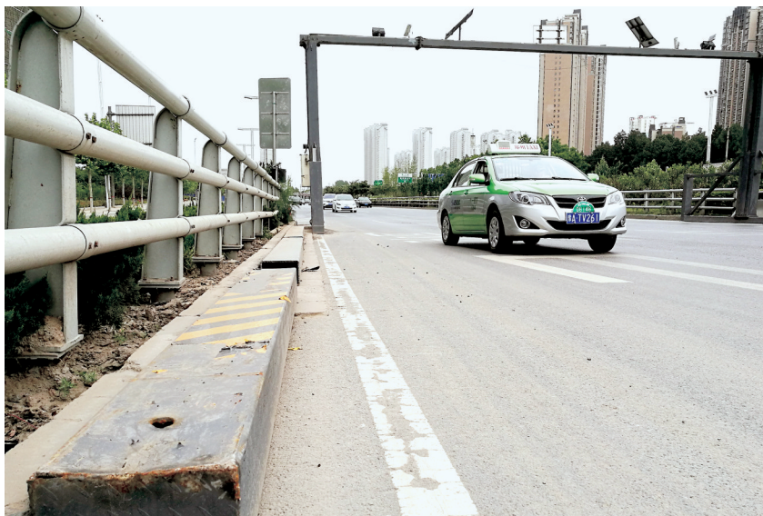
南三环高山路西向东限高装置损毁后部件被丢弃在路边
