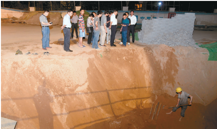
几名建筑工人黑灯瞎火作业,安全隐患大。
