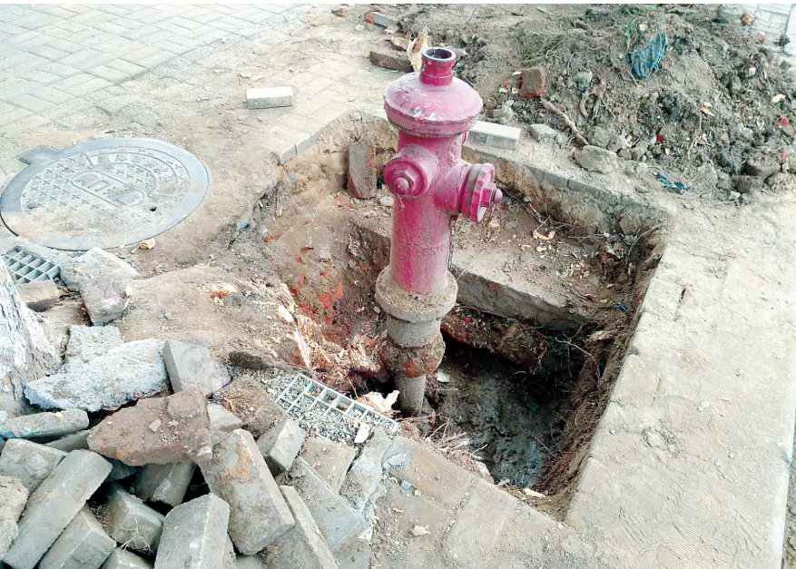
漏水的消防栓
