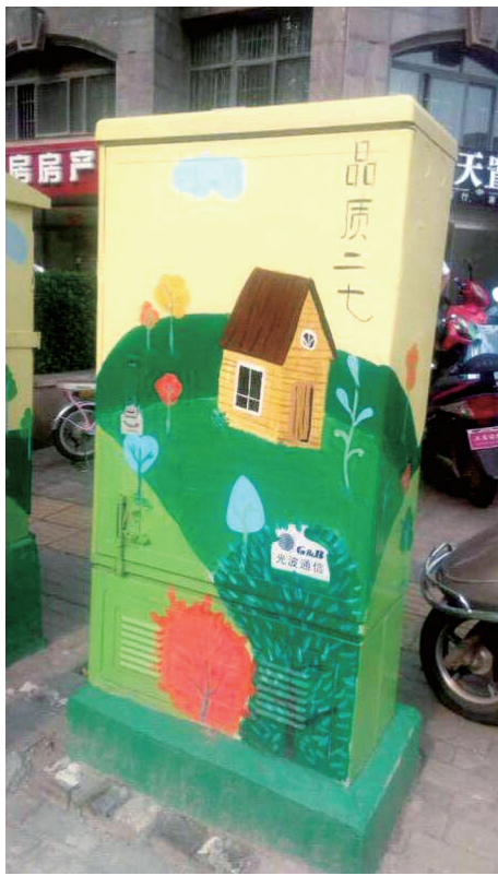
配电箱上的“绿色家园”
