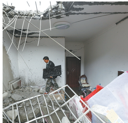
茂县叠溪镇新磨村乔大帅家严重受损
