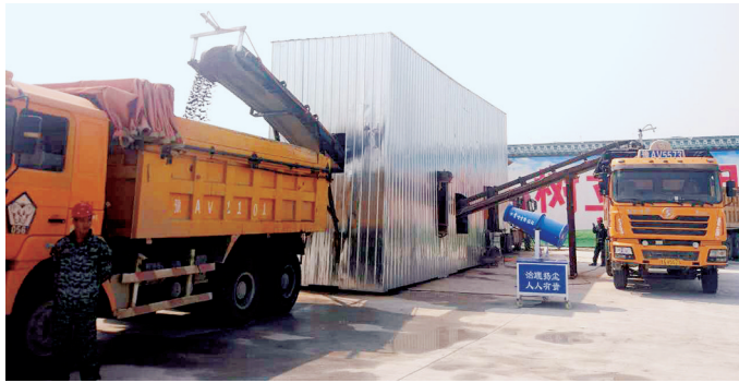
建筑垃圾再利用设备——粉碎机
