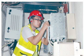
保障网络,巡检室分分布系统
