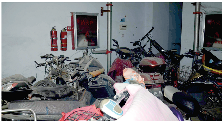
清水湾小区楼内消火栓遭电动车围堵
