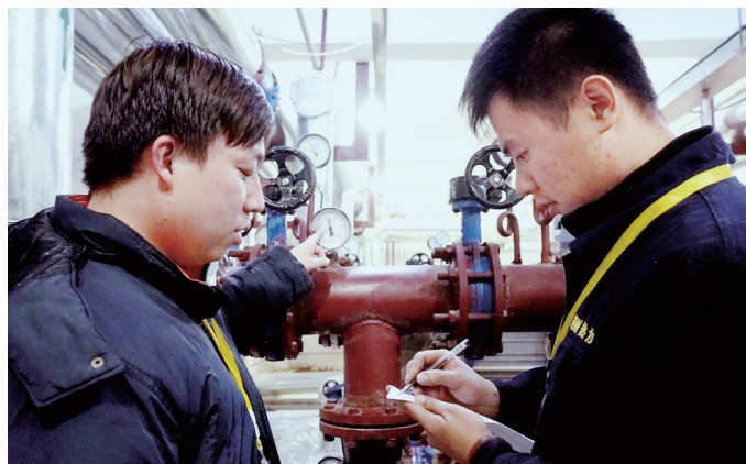
保证居民正常供暖,热力公司工作人员监测管网温度
