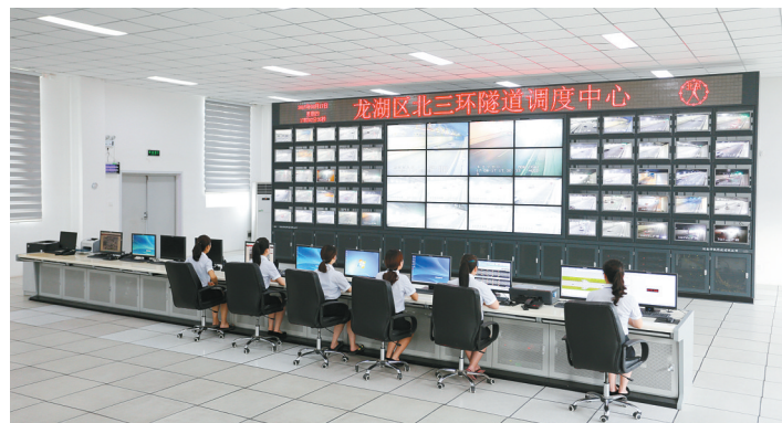
调度中心监控台
