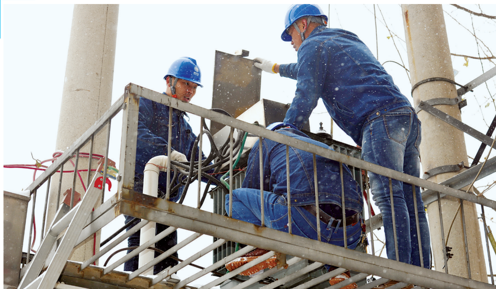
中牟电力工作人员雪中排查故障
