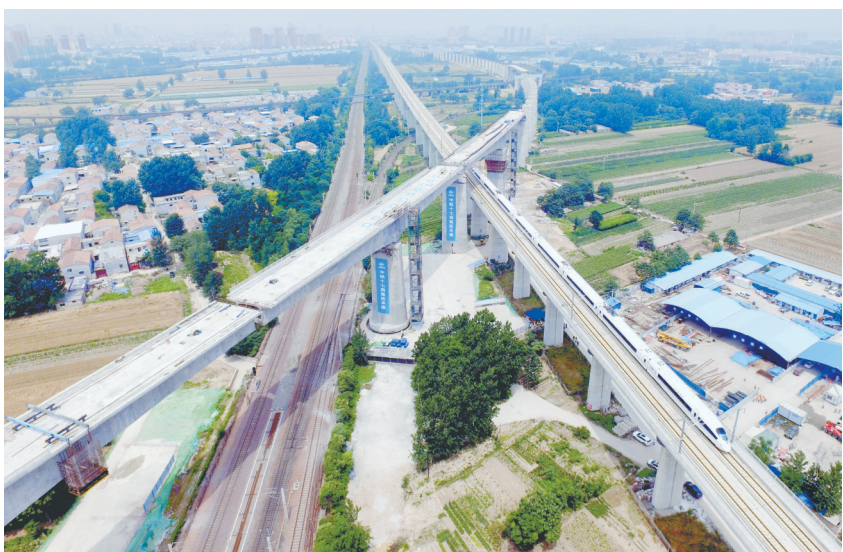
昨日,商合杭高铁上跨既有陇海铁路连续梁转体成功。新华社发
