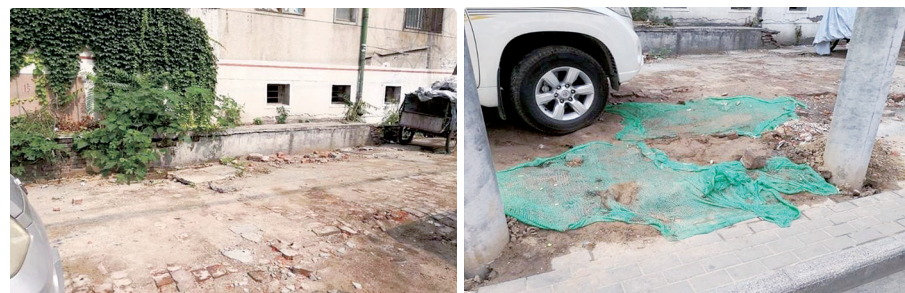
改造前破损严重的道路
