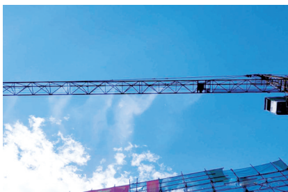
安装了自动开启装置的塔吊喷淋,每到整点自动开始降尘作业
