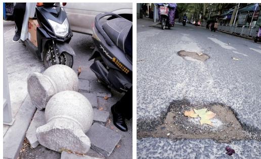
金水路与玉凤路交叉口自行车道上倒着的石墩 经五路与黄河路交叉口路面坑洼不平
