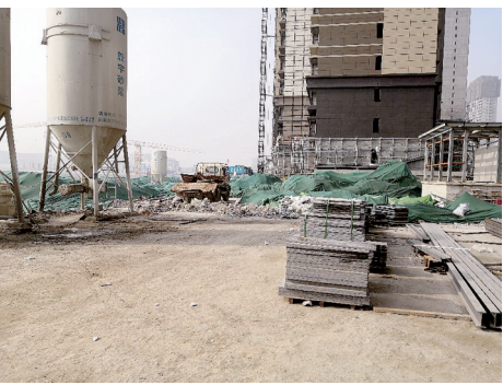
华南城住宅一期二标段物料没有完全覆盖
