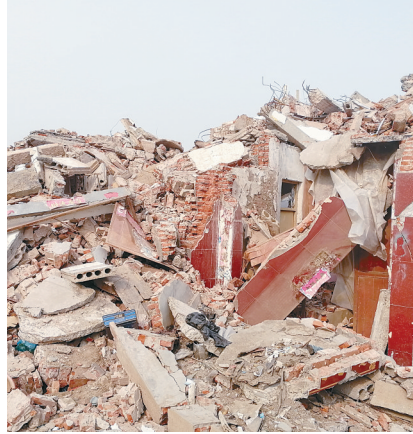
柿园村一拆迁工地建筑垃圾未覆盖
