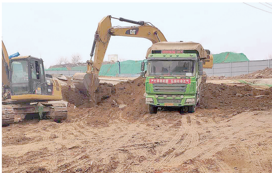
荥阳龙城实验学校工地违规作业,黄土裸露
