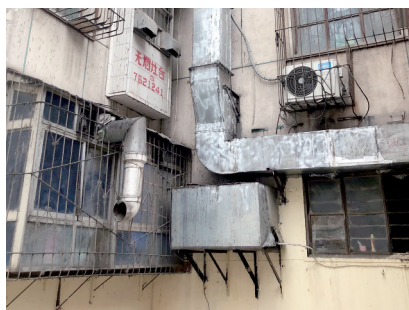
太和路排烟管道
