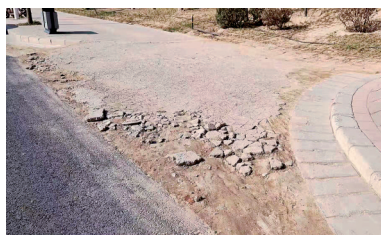
博学路办事处 龙子湖西路 (平安大道-博学路) 道路分类:A类 二级路长:王冲 存在问题:大量暴露垃圾;路边绿化带内大量积存垃圾落叶;侧边石破损;绿化带内缺株;架空线缆;围挡不规范;道板砖破损。 整改措施:重新梳理问题台账,重新明确人,对接相关部门整改。联系沿街单位对绿化带占道经营,包括围挡周边的杂物进行集中整治。
