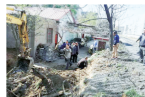
平房院小路大变样 整改前
