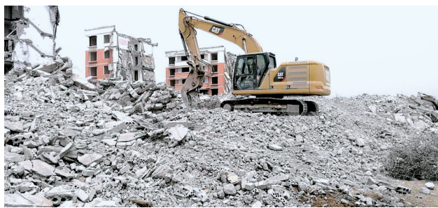
侯寨乡八卦庙村一工地未湿法作业
