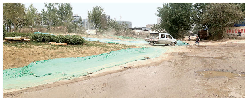
二七区侯寨收费站北侧道路扬尘大
