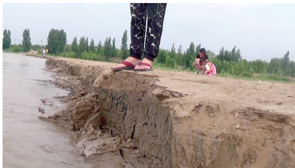
黄河岸经水流冲刷,一不小心就会坍塌
