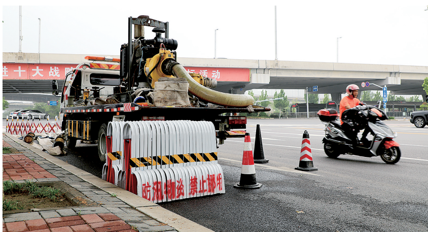
易积水路段抽水设施已到位
