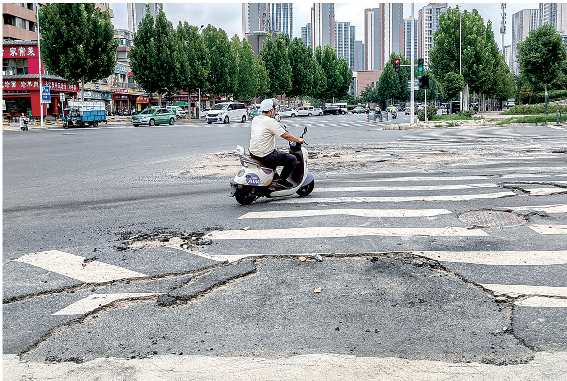
绿水路尧山路口道路破损严重
