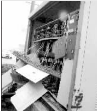
路边被炸毁的高压变电柜
