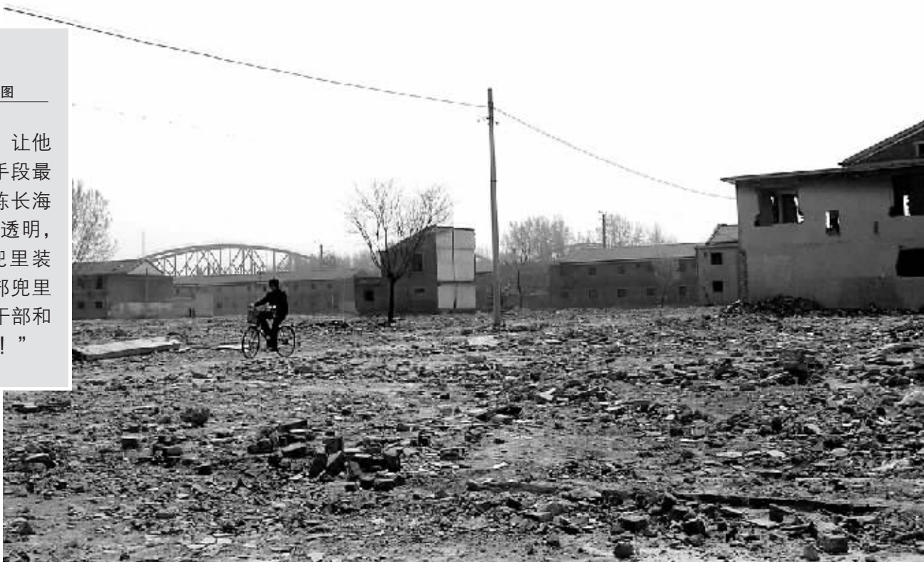
老村已被拆成一片废墟，在不久的将来，这里新建的小区落成后，每户村民可以无偿分到三套住房。
