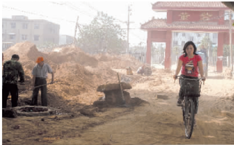
董砦村大门前的路面坑坑洼洼的,风一吹尘土飞扬。 晚报记者 马健 图
