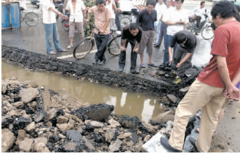
险情排除后,抢险人员查看管道断裂处。
