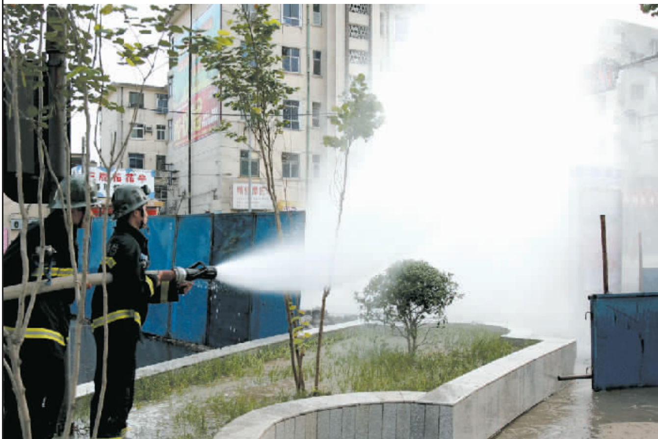
天然气管道被挖破处,气体带着水雾喷射近 4 米高,消防官兵喷水稀释喷出的天然气。晚报记者 周雨 图
