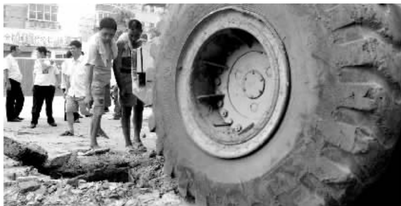
昨日,货站街上被铲车铲断的天然气管道。 晚报记者 王梓 图
