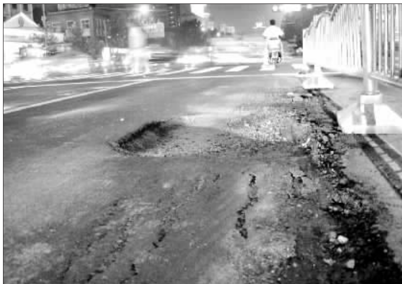
在与纬五路交叉口北50米处,新修的花园路路面已经开始塌陷。晚报记者 周雨 图
