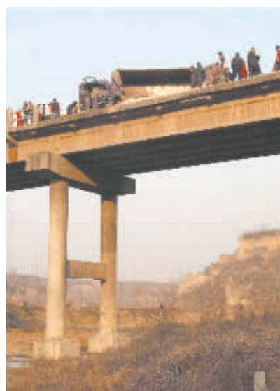
15米高的桥下,车主妻子被埋石砂堆中。
