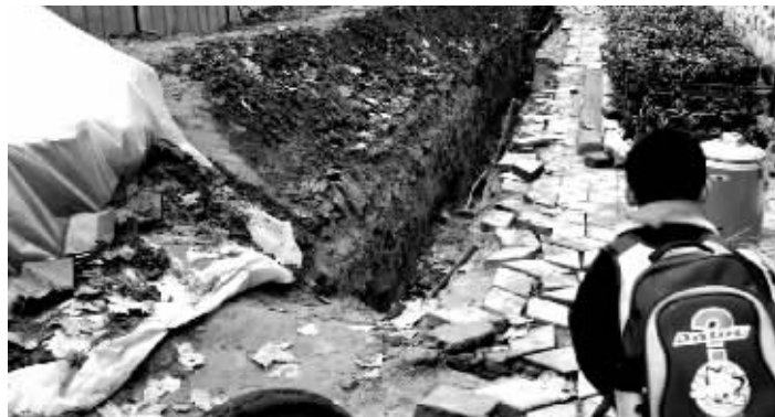
近日，伊河路上挖开的大沟让上学的孩子遭遇“行路难”。
