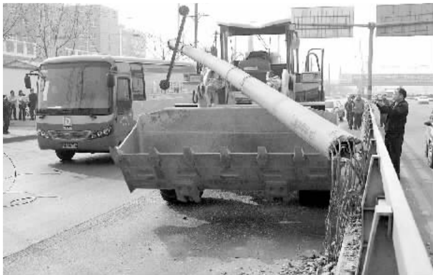
电线杆被拦腰铲断。 晚报记者 王银廷 图
