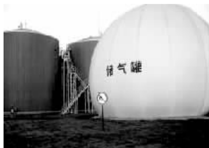
大力发展循环经济的蒙牛在今年初建成了目前全球最大规模的畜禽类沼气发电厂
