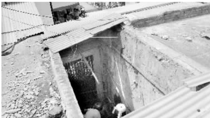
两个孩子就是在这个屋顶,踩上了石棉瓦掉下去的。
