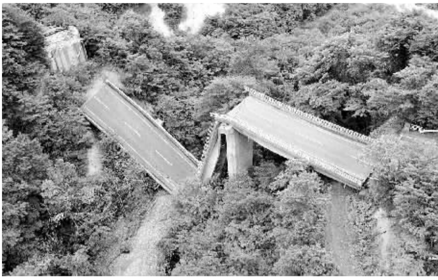
6月14日,一座位于日本岩手县一关市的公路桥在地震后坍塌。新华社/路透
