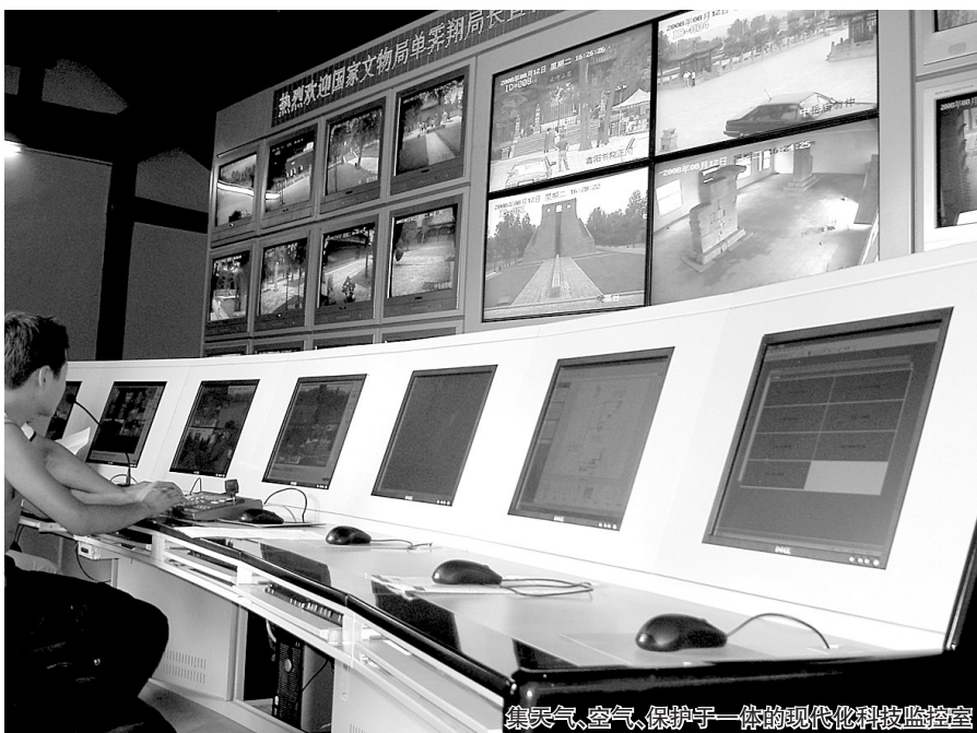
集天气、空气、保护于一体的现代化科技监控室
