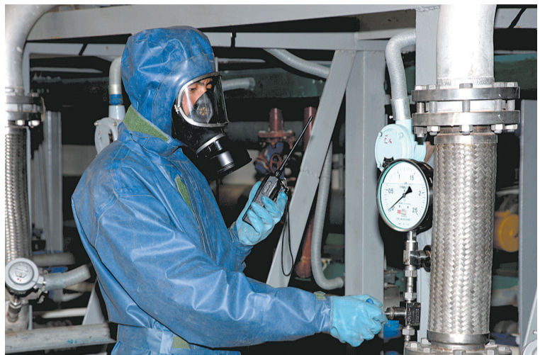
9月24日,工作人员在检查火箭推进剂加注设备。 新华社发
