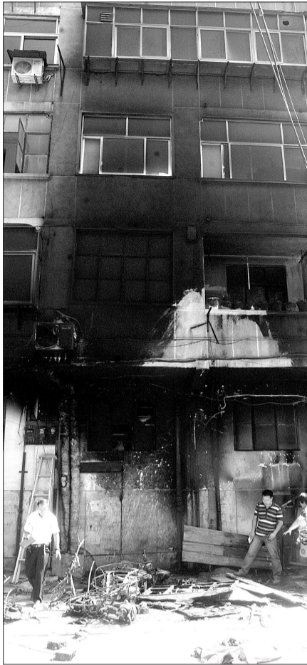
昨日凌晨,城南路与紫荆山路交叉口的家属院内,因电线老化溅落的火花引燃楼下锁在一起的3辆电动车。
